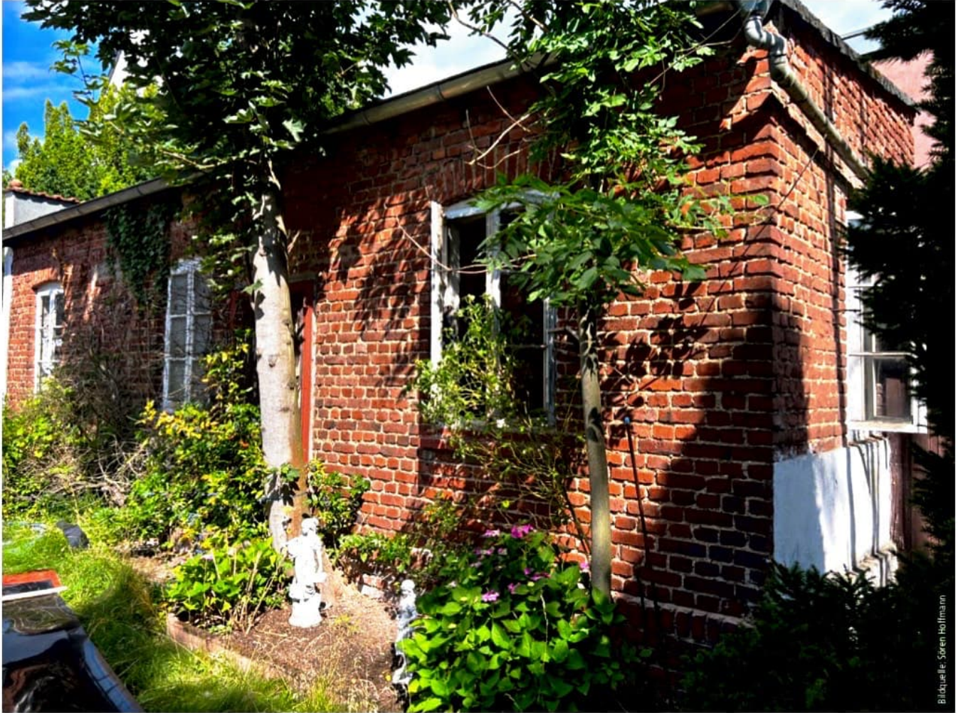
Abb. 1: Das alte Farblager in Leichlingen wies massiven Feuchteintrag im Mauerwerk sowie Putzschäden auf und musste komplett saniert werden.
