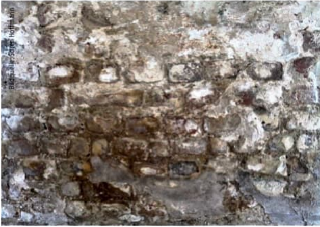
Abb. 2: Schadensbild von durchfeuchtetem Mauerwerk durch kapillar aufsteigende Feuchtigkeit
